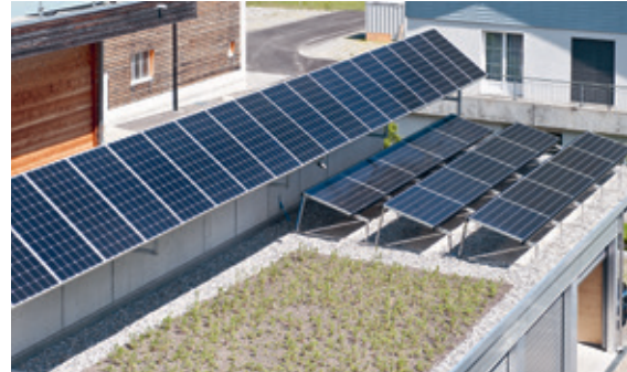
Vorne fixe, hinten sonnengeführte Photovoltaikanlage
